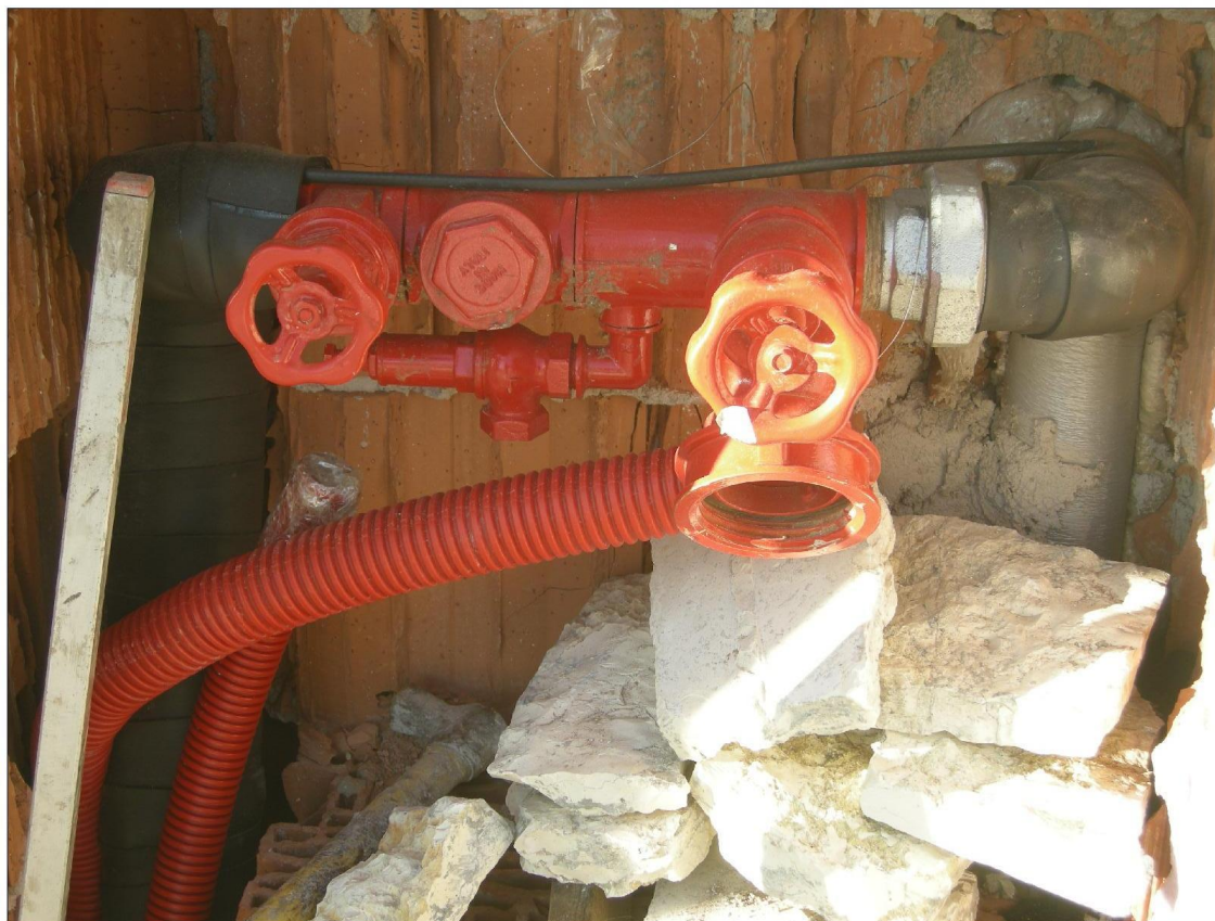
FOTO ANTINCENDIO 7 - ATTACCO MOTOPOMPA VVF
