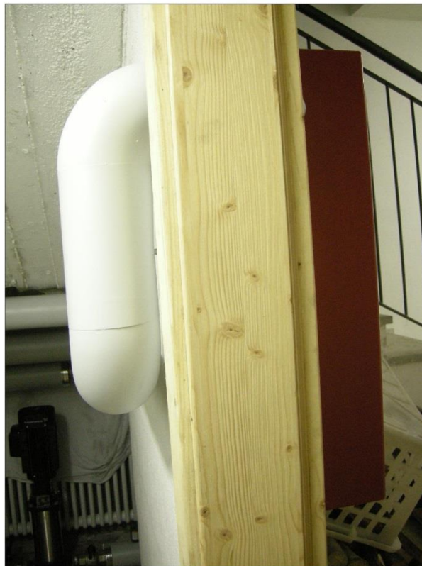
FOTO ANTINCENDIO 6: NASPO UNI 25 PIANO INTERRATO
