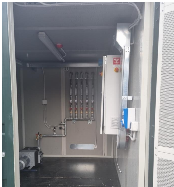
Figura 4.2: vista dell'impianto di MISE.
