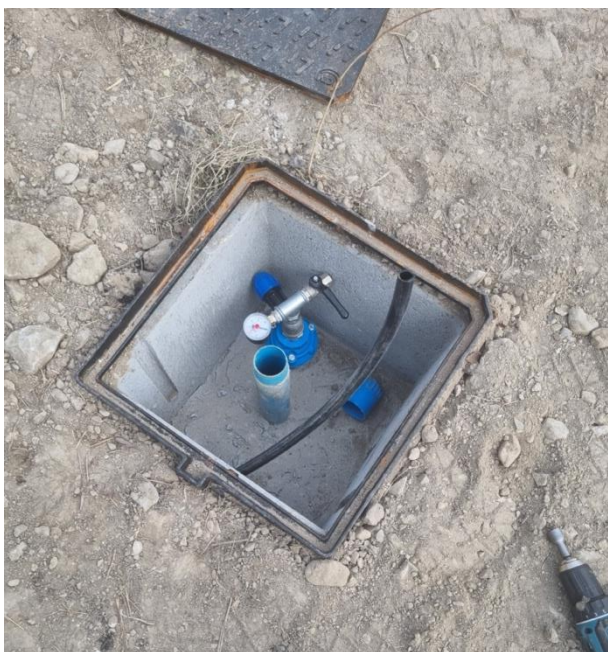
Figura 4.1: Pozzo di sparging.
