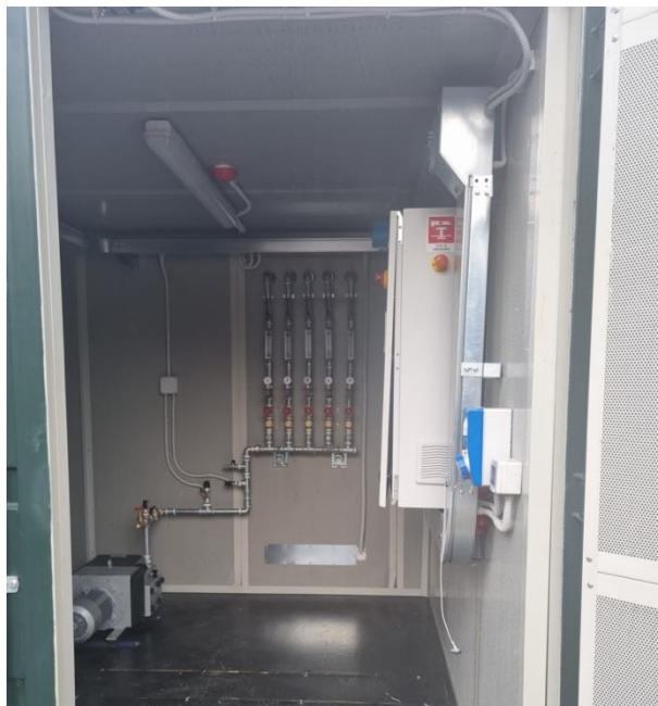
Figura 3.2: vista dell'impianto di MISE.
