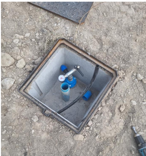
Figura 3.1: Pozzo di sparging.
