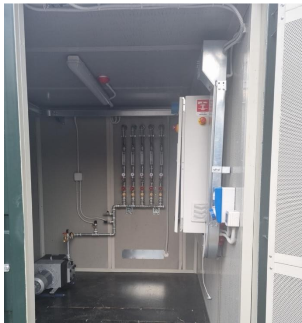
Figura 4.2: vista dell'impianto di MISE.
